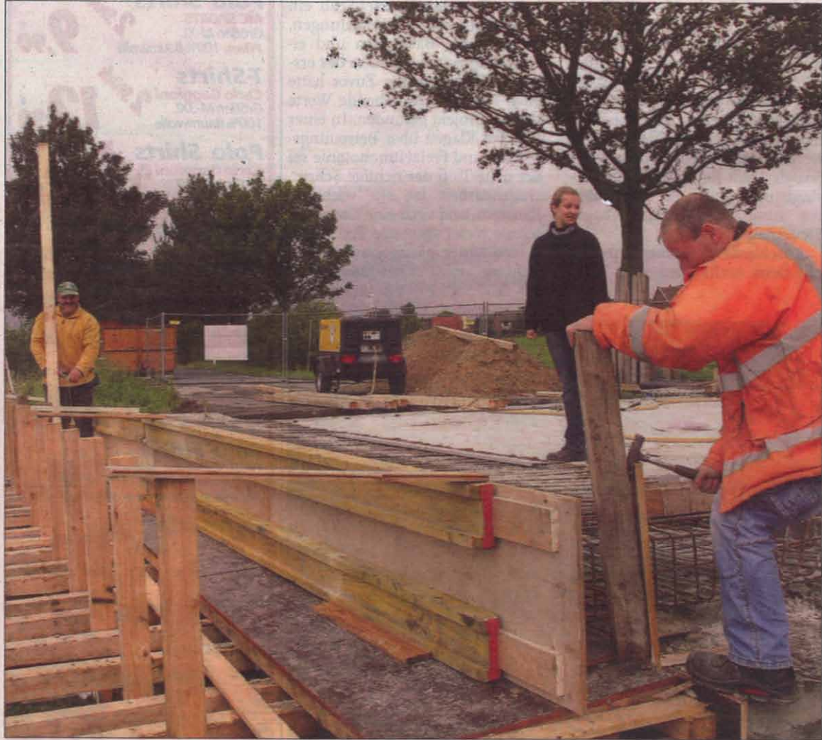
Wolf-Dieter Quaadt (von links), Marie Süllwold und Maik Pfortner sanieren im Auftrag der Region Hannover die 114 Jahre alte Mösekebrücke an der Kreisstraße 245 zwischen Barrigsen und Ostermunzel. Hermann
