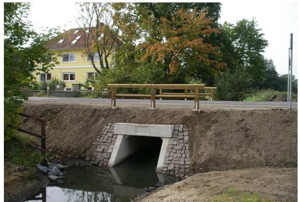
<p>Durchlass in Betrieb</p>
