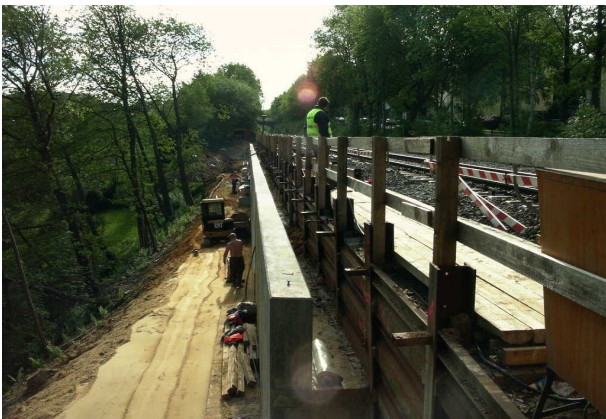
<p>Stützwand mit Trägerbohlverbau zur Gleissicherung</p>
