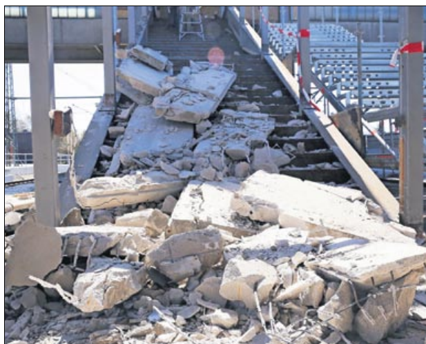
Kein Durchgang: Schutt überall.
