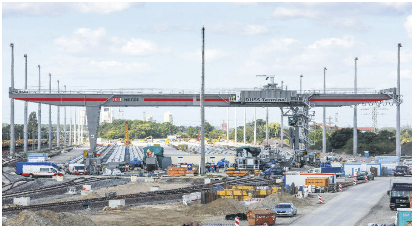
Oskarreif: „Das Gleisbau, Abbruch, Bahnsteig-, Beton-, Hoch- und Erdbau aus einer Hand angeboten werden können, ist eine Seltenheit und am deutschen Markt schwer zu finden – außer, man kennt Albert Fischer“, hieß es in der Laudatio der Verleihung des Großen Preises des Mittelstands im zurückliegenden Oktober. Das Bild zeigt übrigens den Megahub bei Lehrte, dessen Bau das Unternehmen aus Elze wesentlich durch modernste Ausführungsvarianten geprägt hat.
