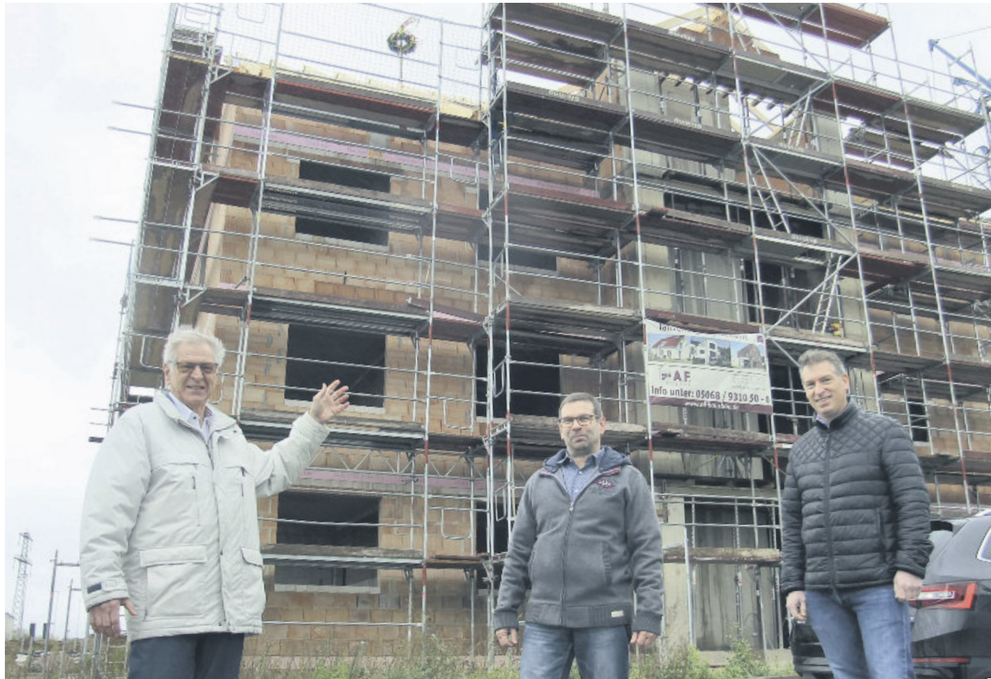
Der Richtkranz weht über dem Zwei-Millionen-Euro-Neubau (v.l.): Albert Fischer, Marc Booß und Peter Fischer feiern vor dem hiesigen Bürogebäude der Albert Fischer GmbH, das am Heilswannenweg entsteht, Richtfest.
